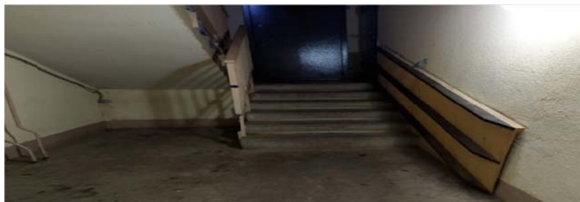
Рис. 3. Фото из дома с неправильно установленным пандусом
